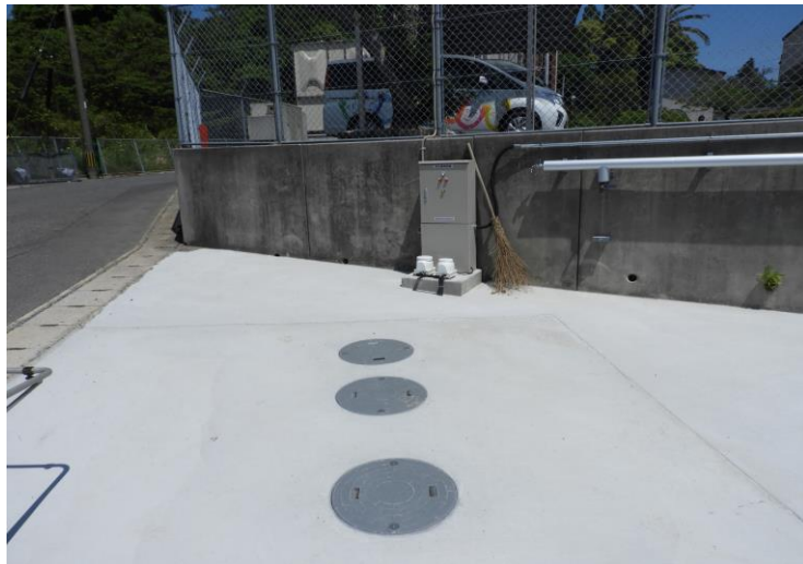
新作業棟用浄化槽
